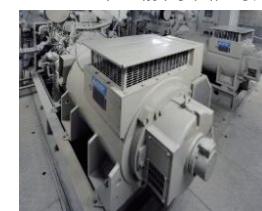
非常用発電機
